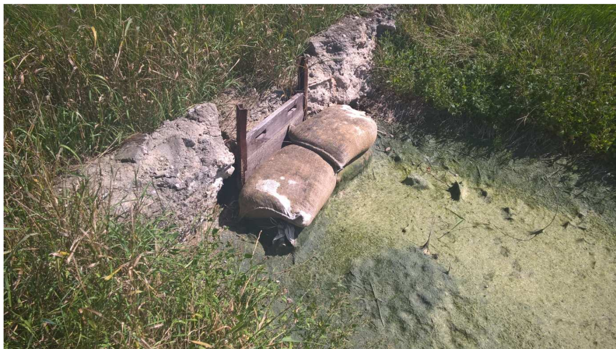
Przyczółek wlotowy – widoczne uszkodzenia i zdewastowana zastawka.
